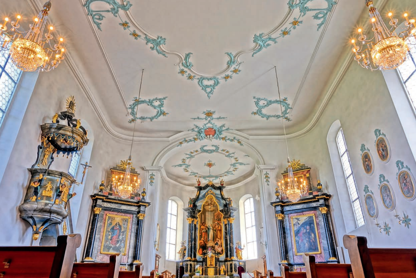
Blick in den neu erleuchteten Kirchenraum von St. Luzia: hier können nun per Knopfdruck individuell vorprogrammierte Szenarien abgerufen werden – mit neuester LCC-Technologie (HDR-Bilder: Markus Frutig, ET Licht).
